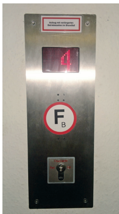
Abb. 4.8: Anzeigeta- bleau eines Aufzuges mit verlängerter Betriebszeit
